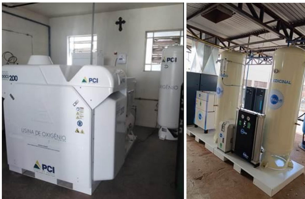
Figura 3 - Usina de Oxigênio da Santa Casa de São Joaquim Da Barra
